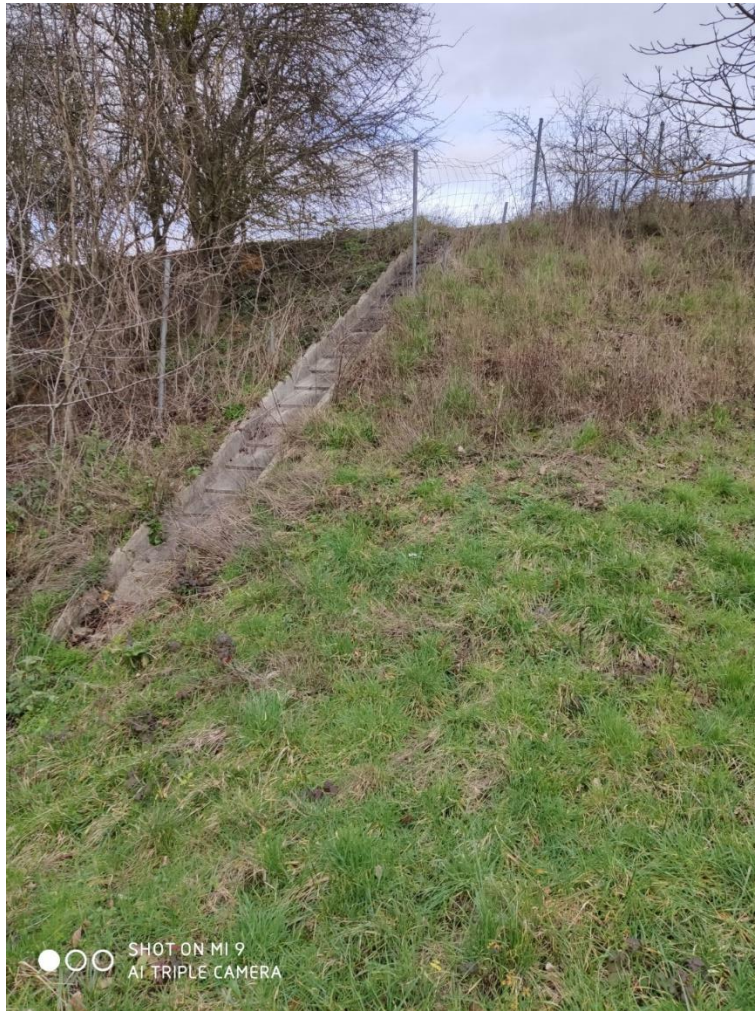
Figure 37 C:\Users\m_cha\Desktop\Heudebouville SAPN\photos\bv3\2020-02-05_15-14-13.jpg bv3 : Descante d'eau du passage inférieur dela RD
