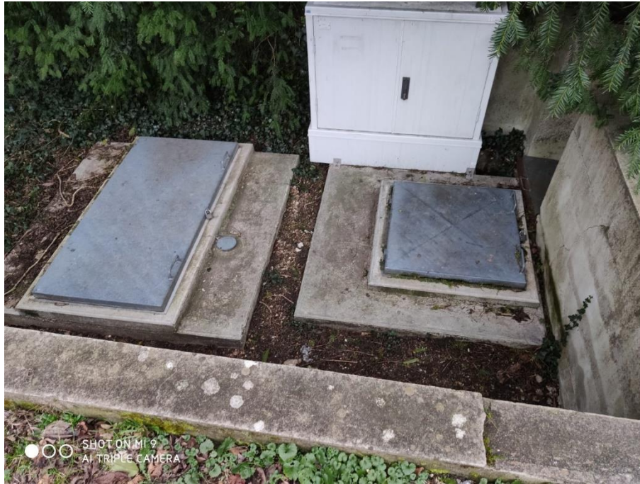
Figure 5 C:\Users\m_cha\Desktop\Heudebouville SAPN\photos\bv1\2020-02-05_17-50-23.jpg bv1 : Le D500 PVC passe près de la station de relèvement des EU chez le riverain
